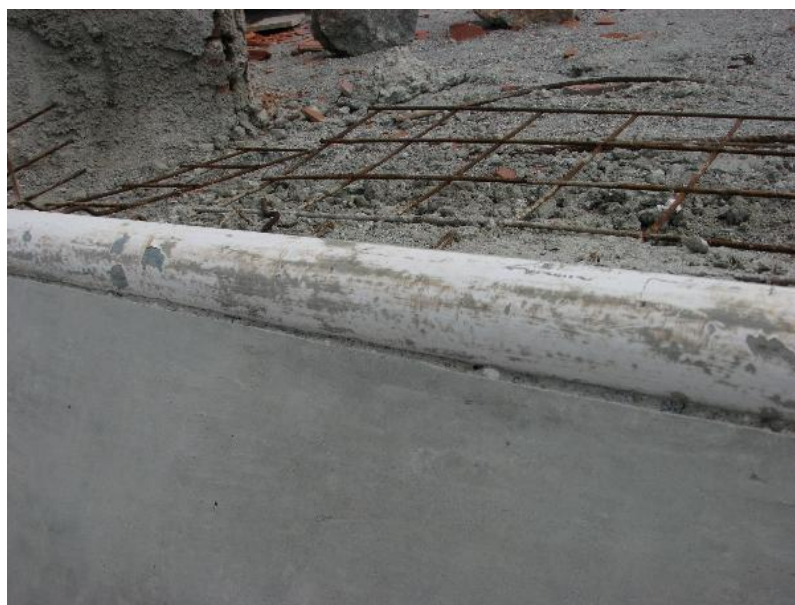
Figura 10 - Junta entre o concreto e o tubo que deverá ser preenchida com poliuretano. Fonte: Google
